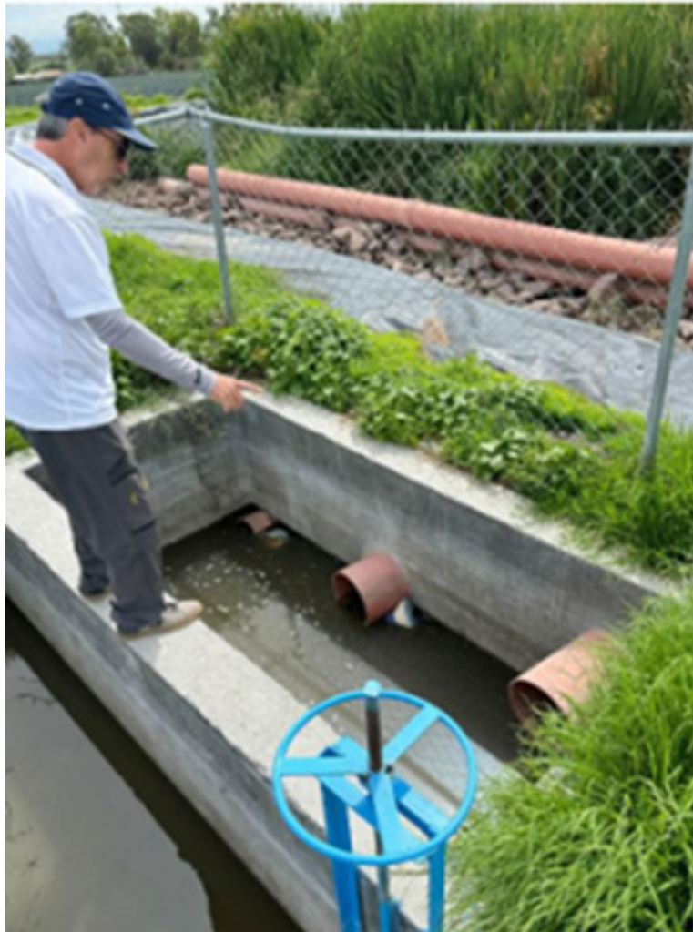
Figura 9. Caja de niveles del agua tratada del HASS en SDA.
